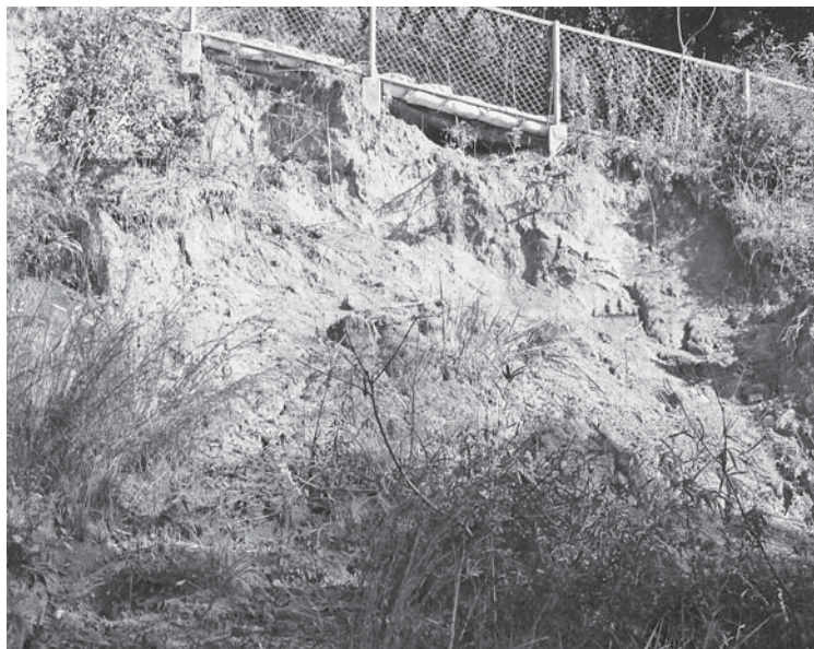
町道こいこい橋線の法面崩壊場所
