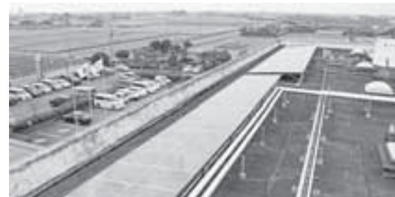
役場屋上に設置されている太陽光発電パネル
