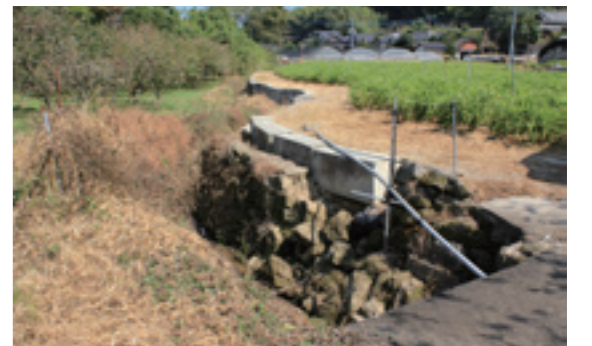
水害で壊れた用水路(中大野地区)
