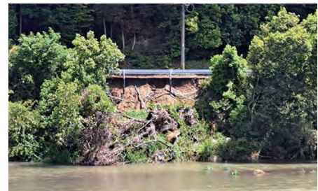
氷川右岸堤防の災害現場
