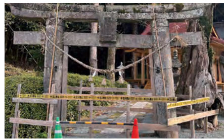
横木に損傷が確認された立神熊野座神社の鳥居
