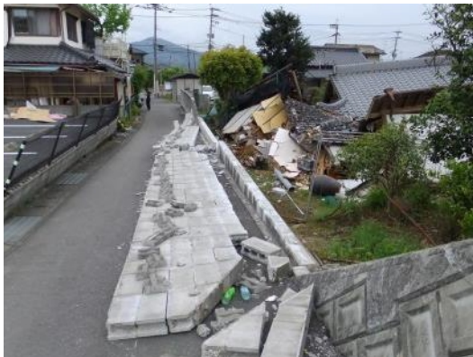
図 ブロック塀の倒壊
