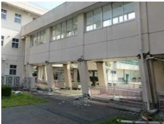
図 渡り廊下の倒壊（校舎）
