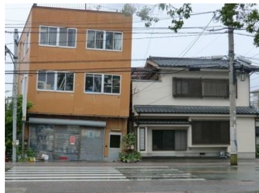
図 液状化による建築物の傾斜
