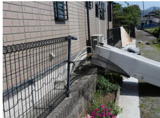
図 給湯施設の転倒
