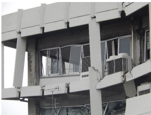
図 庁舎棟の局部崩壊
