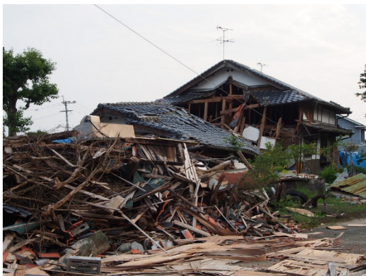
図 住宅の倒壊状況
