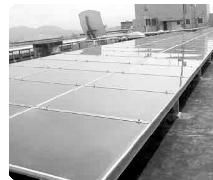
▲屋上に設置された太陽電池パネル
