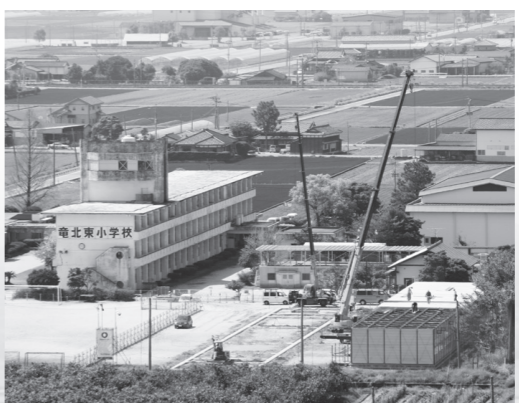
耐震工事を前に仮校舎の建設が始まった竜北東小学校
