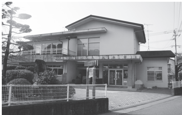
▲老朽化が課題となっている現八火図書館
