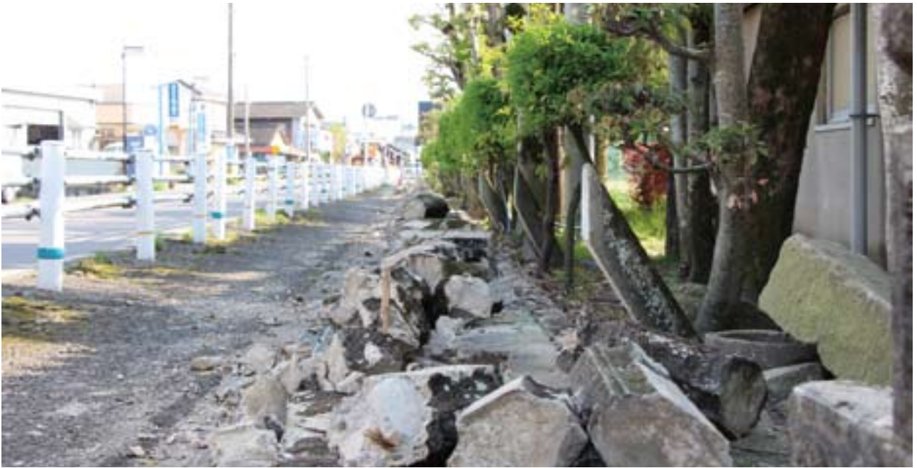
▲崩れた壁（竜西小）
