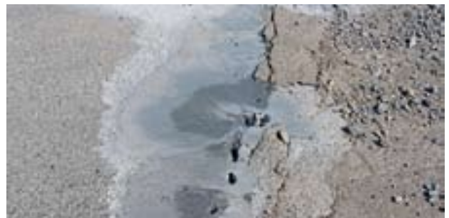
▲液状化したコンクリート
