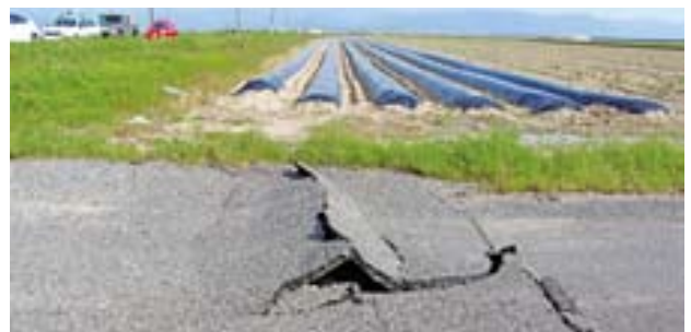
▲破損した道路
