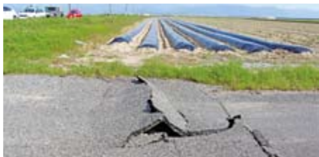
▲破損した道路
