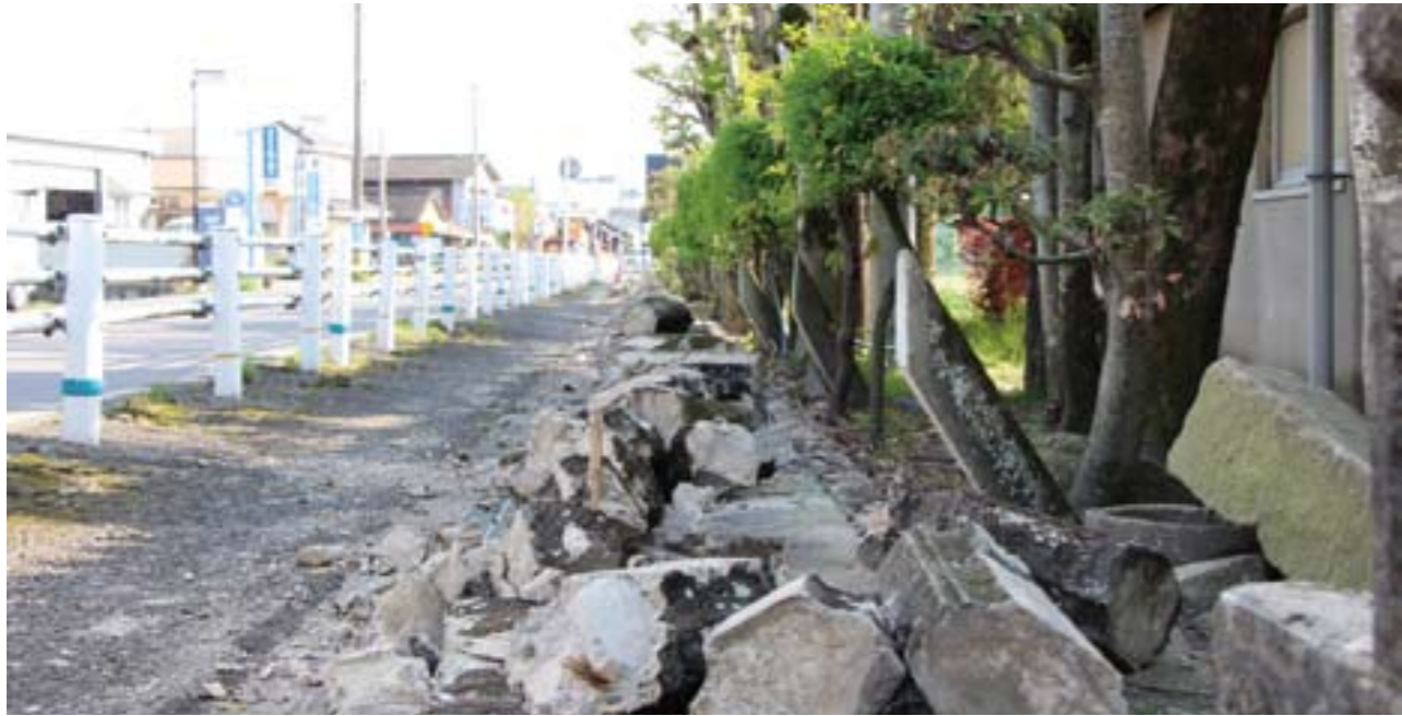
▲崩れた壁(竜西小)
