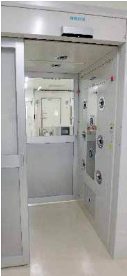
▲クリーンルーム入口のエアージャワー室
