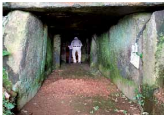
▲天井石の隙間から落ちた古墳の土
