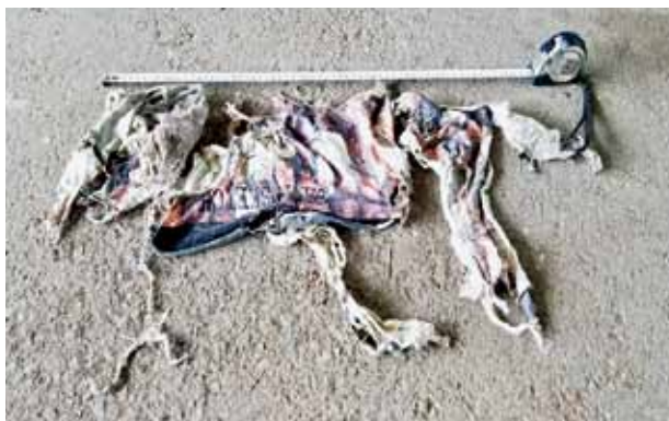
▲ポンプに詰まっていた衣類(吉本地区)
